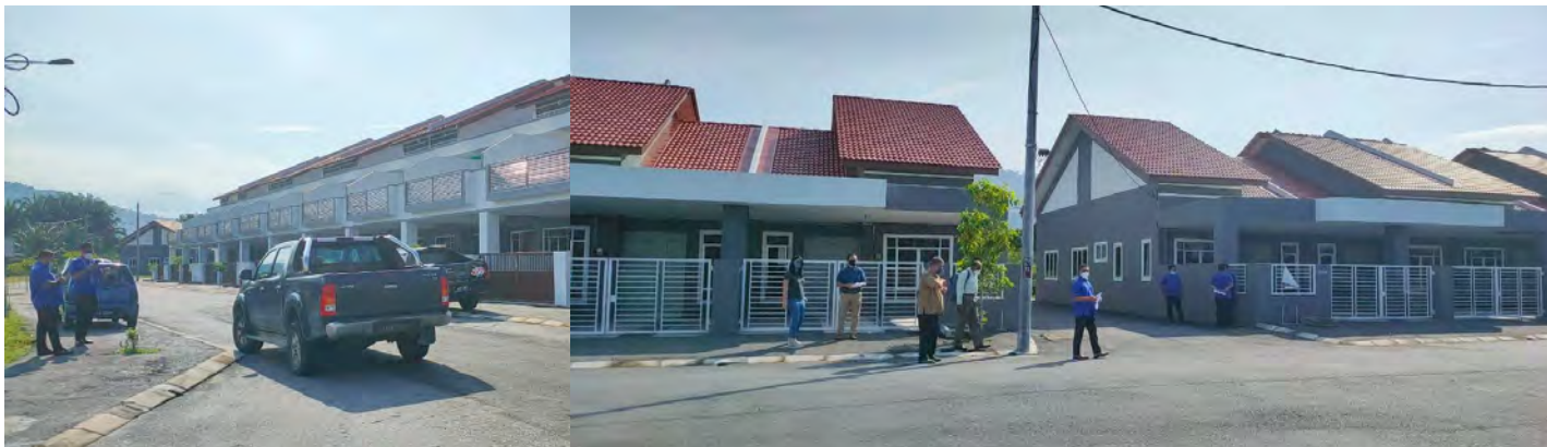
Cadangan Membina 24 Unit Rumah Teres Setingkat Di Atas PT 17382 Hingga PT 17405, Mukim Kampar, Daerah Kinta, Perak Untuk Tetuan Taiping Kampar Development. - Fasa 2 Bagi 17 Unit Rumah Teres Setingkat Di Atas PT 17389 Hingga PT 17405
